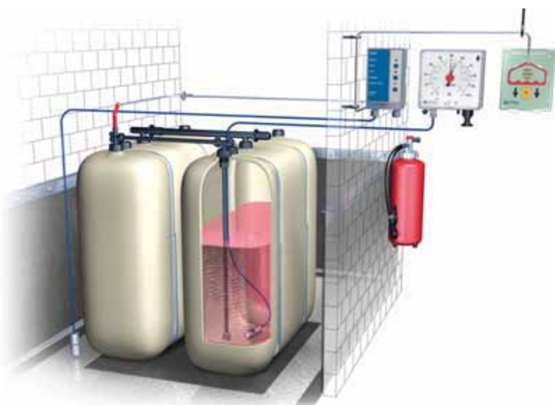
Den Tankraum unter Kontrolle mit WATCHDOG, UNITOP und Reißleine.
